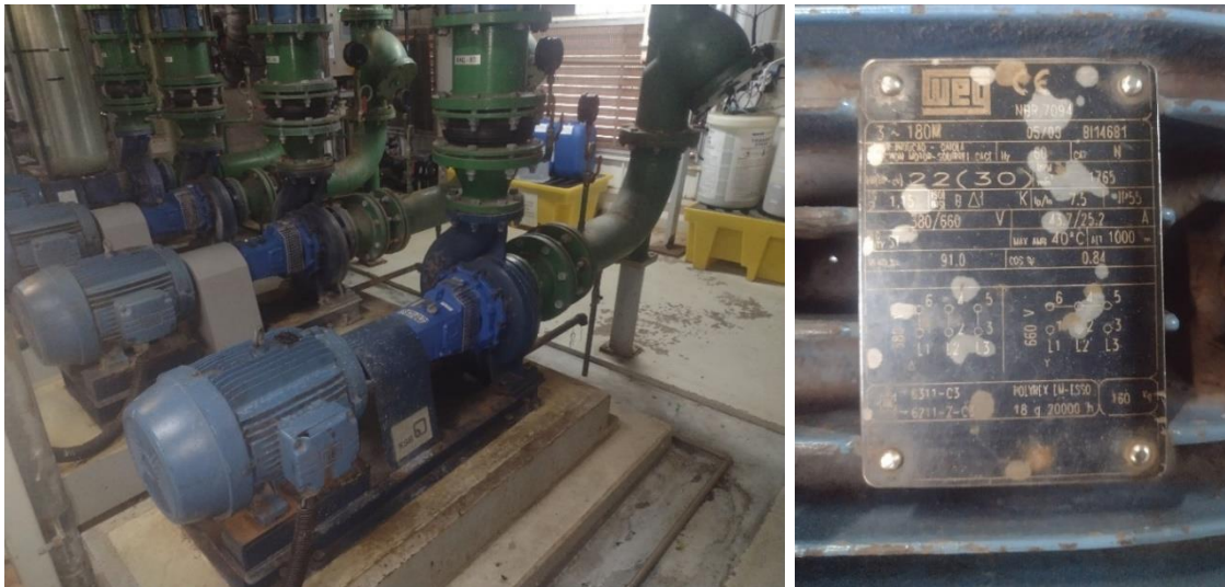
Figura 10 – Bombas secundárias 03 e placa de identificação
