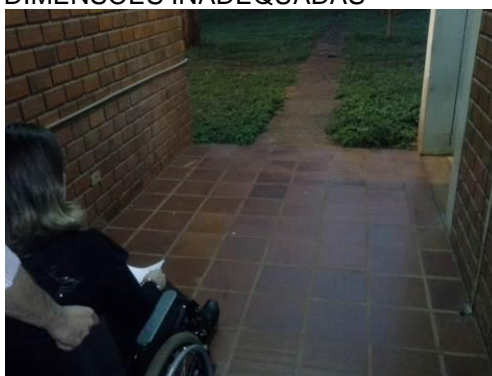
FIGURA 20 – PASSARELA COM DIMENSÕES INADEQUADAS
