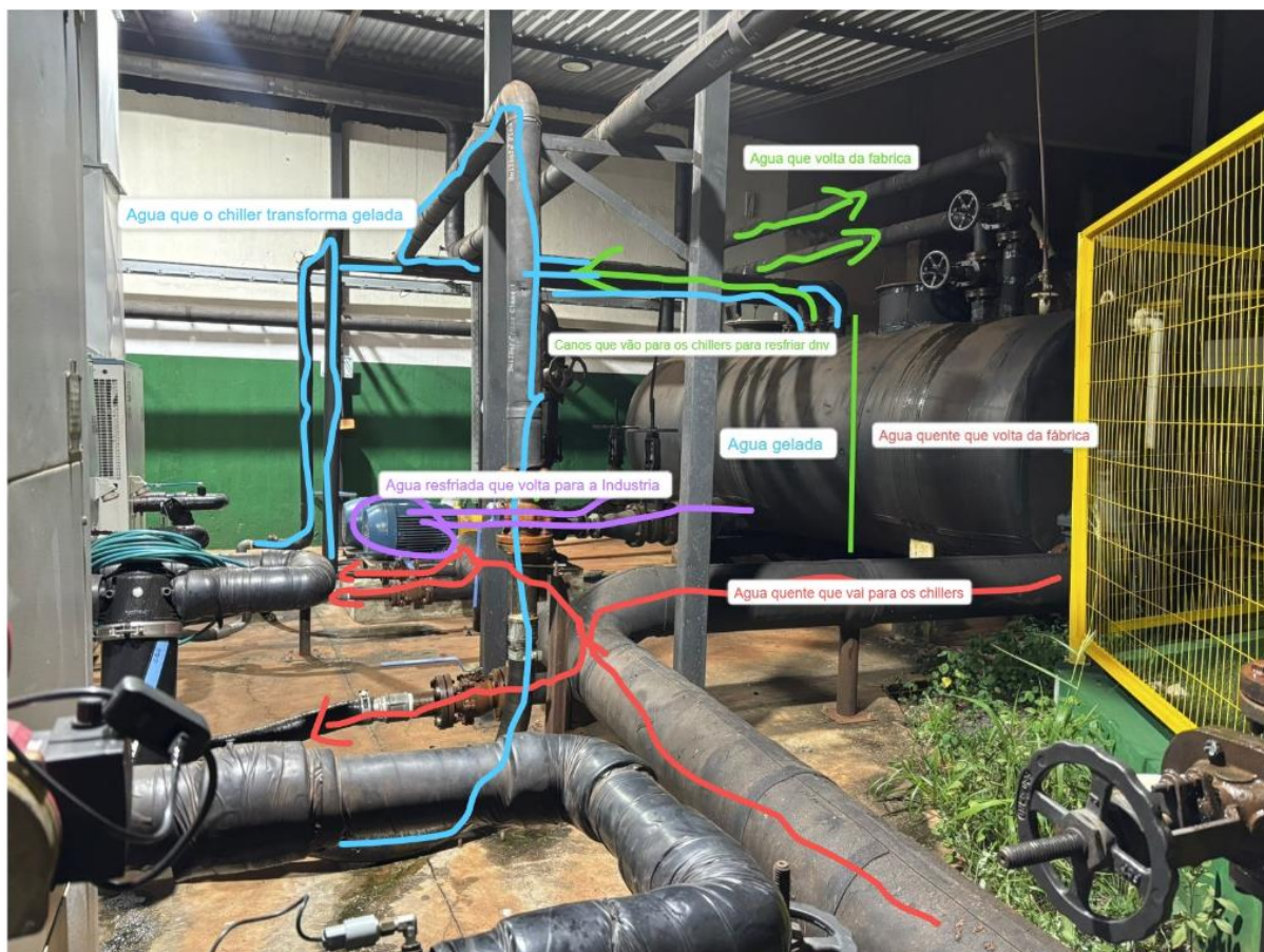
Figura 1 – Sistema de Água Gelada Chiller
