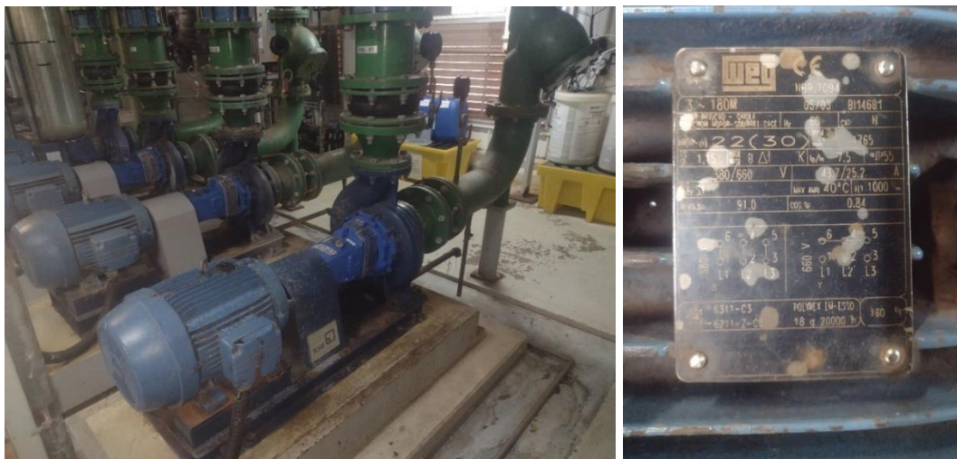
Figura 10 – Bombas secundárias 03 e placa de identificação
