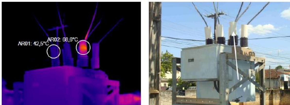
Figura 4 - Imagem de aquecimento na conexão da bucha ao cabo, fase B, de um religador na SE de Jataizinho
