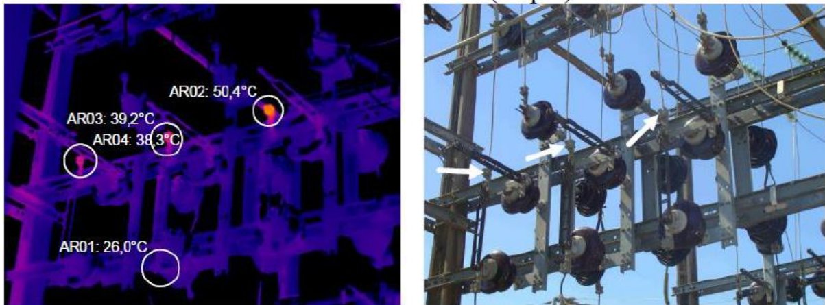
Figura 6 - Imagem de aquecimento no conector ao cabo, fase A, fase B e fase V, de uma seccionadora na SE de Ibaíti
