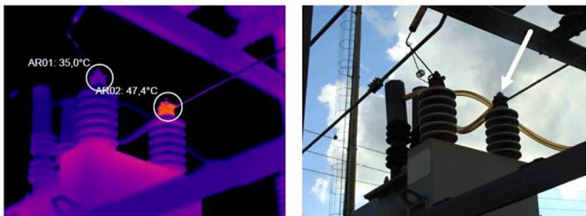
Figura 1 - Imagem Elemento Capacitor – SE Bandeirantes (Copel)
