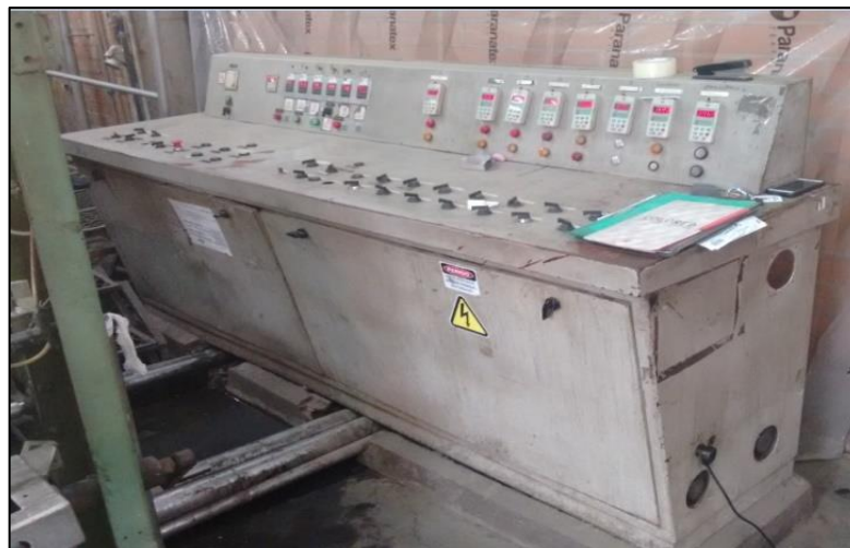
Figura 4: Painel de controle e mesa de operação antiga.
