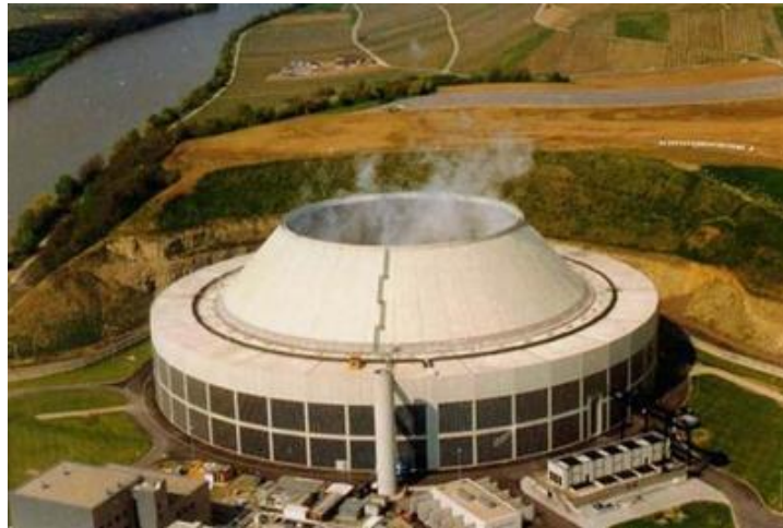
Figura 5 – Torre de resfriamento
