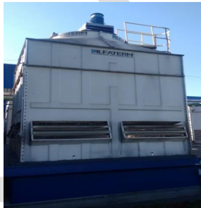
Figura 8- Torre de resfriamento por tiragem mecânica induzida
