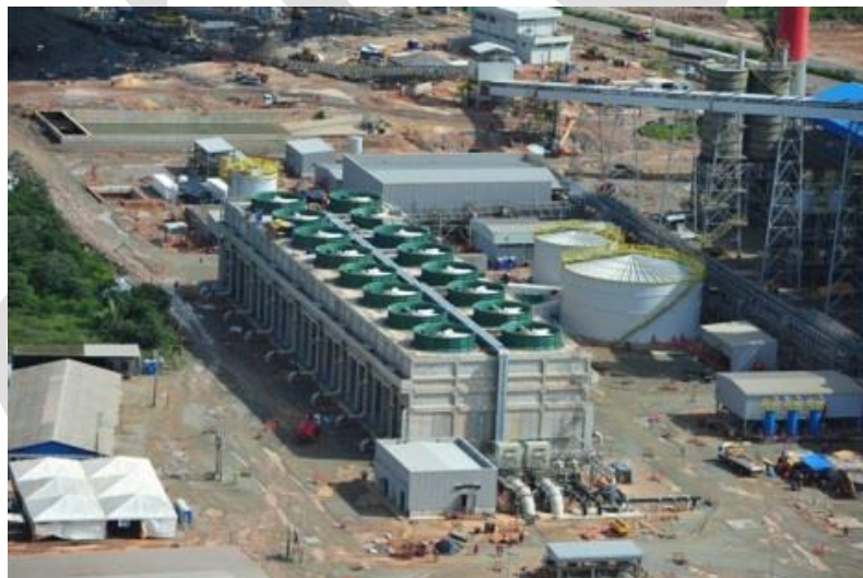
Figura 4 – Torres por tiragem mecânica
