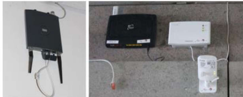
Figura 35 Estrutura de comunicação contendo acesso WIFI, sensor Z-wave de coleta de concentração de CO2 e gateway Z-wave.
