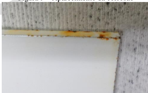
Figura 9 – Aparecimento da corrosão
