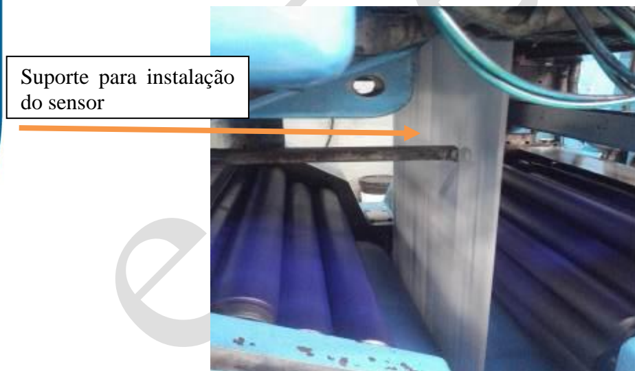
Figura 11 – Instalação do sensor na torre de impressão
