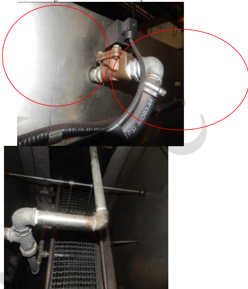
Figura 5 – Válvula e Tubulações
