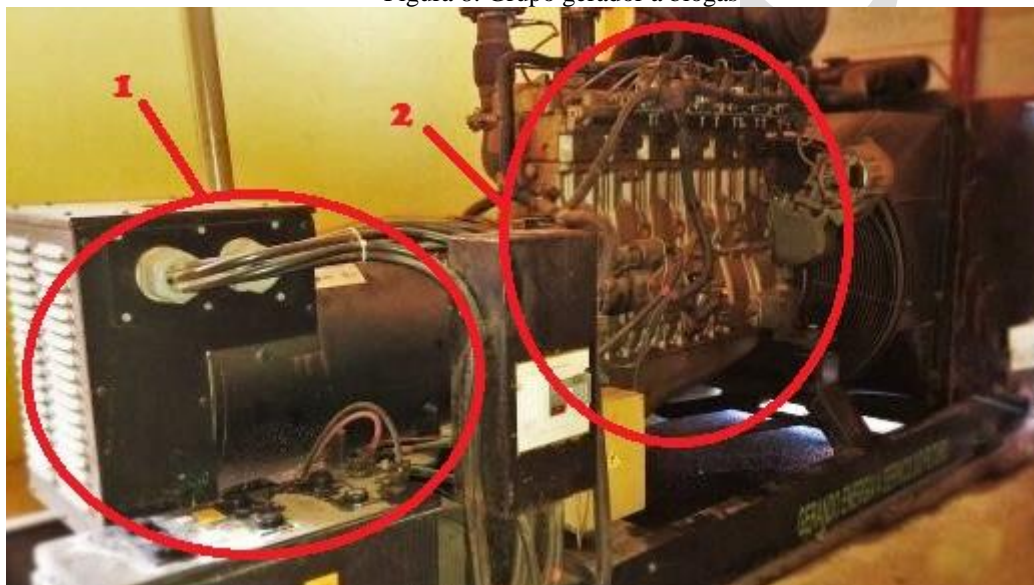
Figura 8: Grupo gerador a biogás
