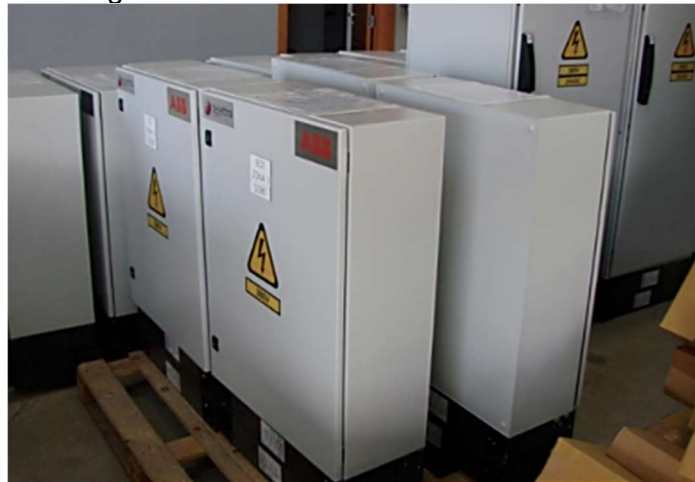
Figura 8 – Painel elétrico de baixa tensão
