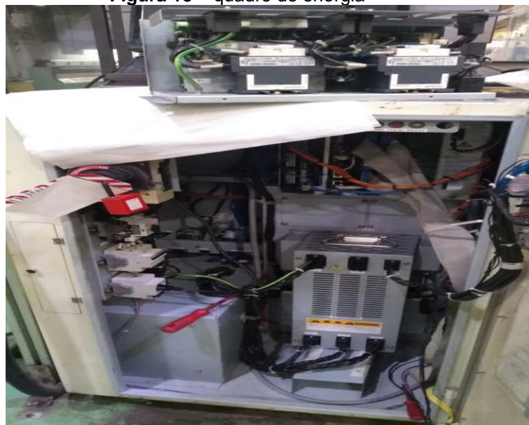
Figura 18 – quadro de energia
