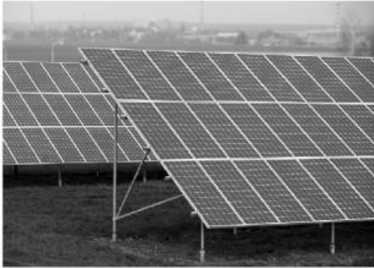
Figura 1 – Usina de Eletricidade fotovoltaica
