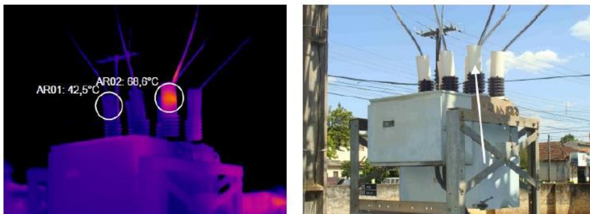
Figura 4 - Imagem de aquecimento na conexão da bucha ao cabo, fase B, de um religador na SE de Jataizinho
