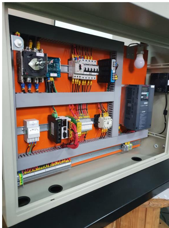
Figura 2: Painel de controle novo.
