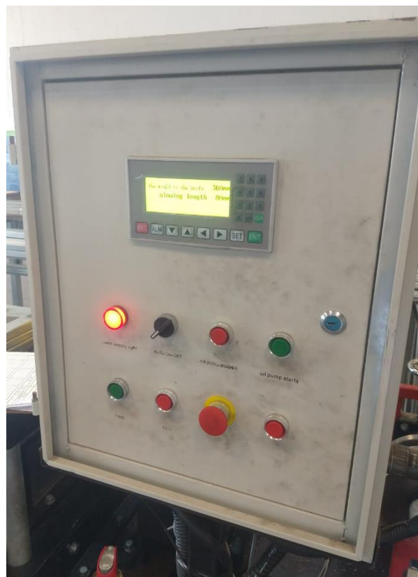
Figura 2: Vista frontal do painel elétrico original.
