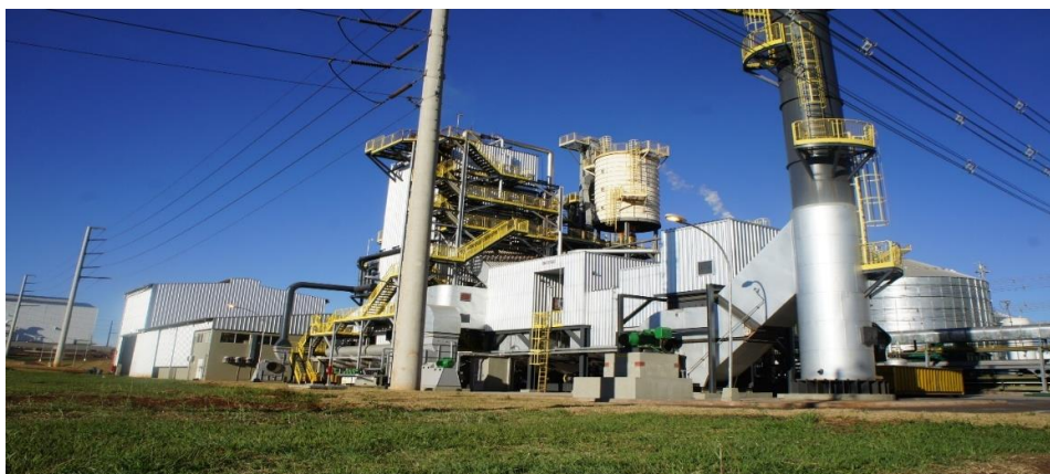
Figura1 - Caldeira água-tubular marca Burntech modelo Biocal 40 ton/h
