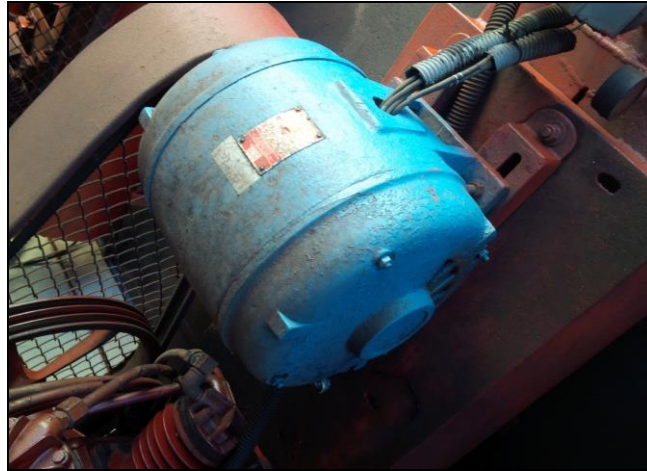
Figura 11 – Motor do compressor.
