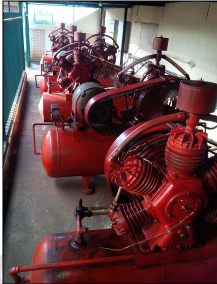
Figura 7 – Foto do banco de compressores.
