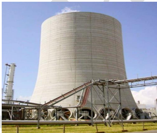
Figura 10 – Torre de resfriamento por tiragem forçada
