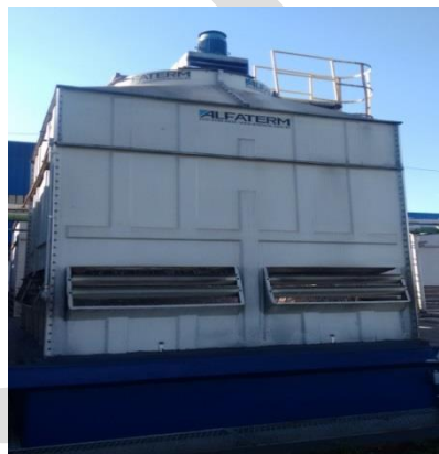
Figura 8- Torre de resfriamento por tiragem mecânica induzida
