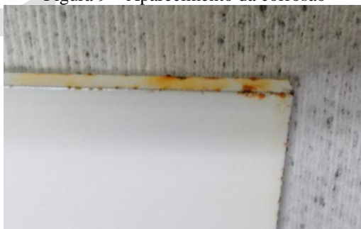
Figura 9 – Aparecimento da corrosão
