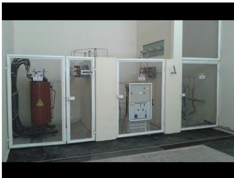
Figura 9 – Cabine de Alvenaria
