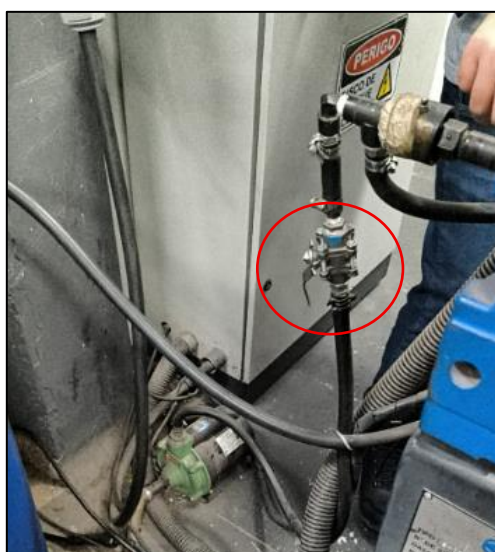
Figura 2: Válvula de acionamento da água
