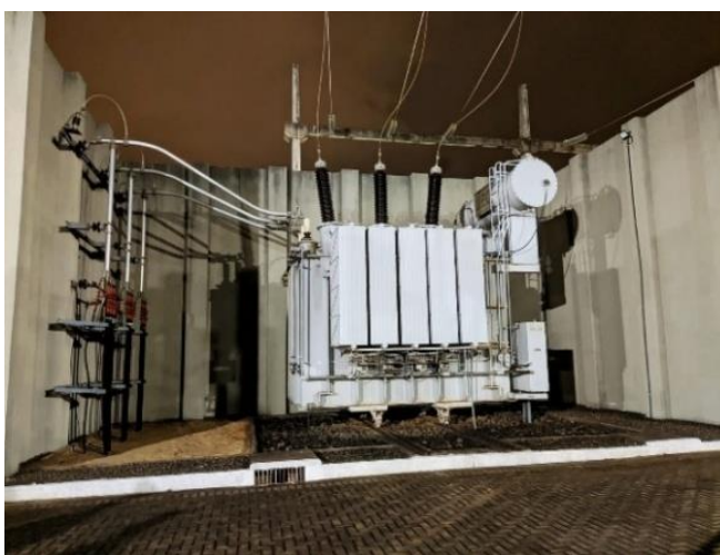
Figura 1: Transformador da subestação igapó 138KV.
