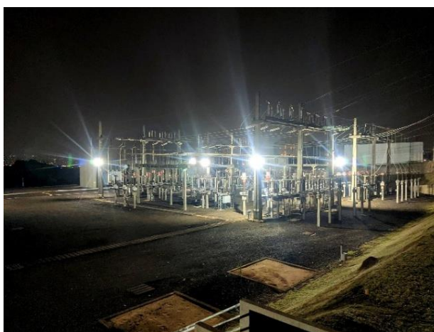
Figura 3: Subestação igapó 138KV.
