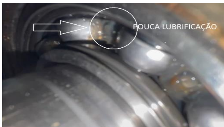
Figura 10 – Rolamento com deficiência de lubrificação
